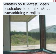
vensters op zuid-west : deels beschadwd door uitkraging ; oververhitting vermijden
