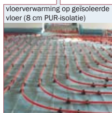
vloerverwarming op geïsoleerde vloer (8 cm PUR-isolatie)
