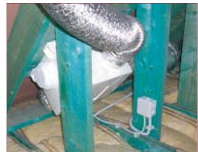
ventilator voor luchtafvoer op zolder boven het geïsoleerde plafond
