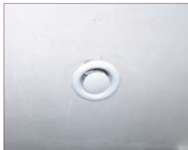
luchtafvoerrooster in badkamer
