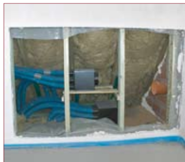
toe- en afvoerbuizen: nog aan te sluiten op ventilator met warmteterugwinning
