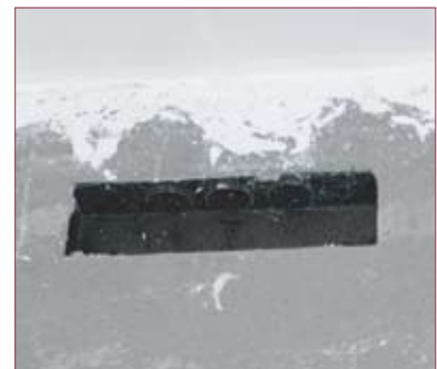
opening voor mechanische afvoer in badkamer: nog verder af te werken
