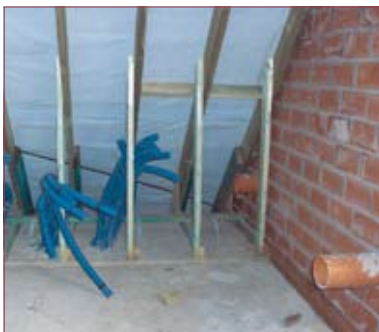
verzamelplaats van toe- en afvoerbuizen in dakholtte naast zolderruimte
