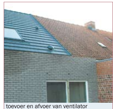
toevoer en afvoer van ventilator
