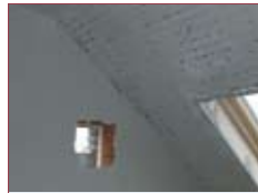
ventilatieopening slaapkamer achteraan - muurrooster nog te plaatsen
