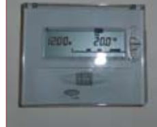
kamerthermostaat in woonruimte
