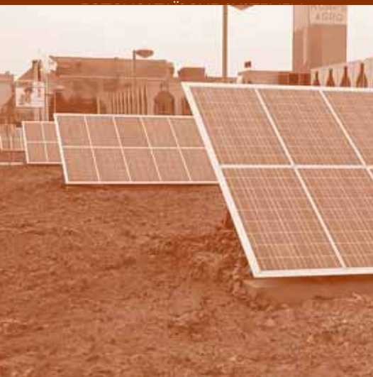
PV-systeem op begane grond in Leuven (Iverlek)
