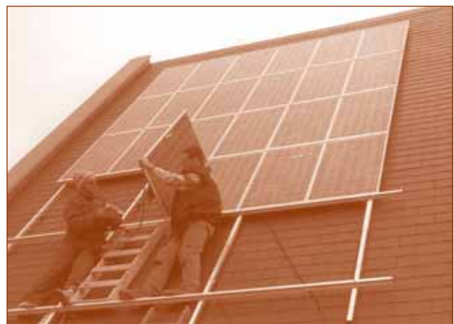
PV-systeem in opbouw op een leidendak (Lenoir Solar)
